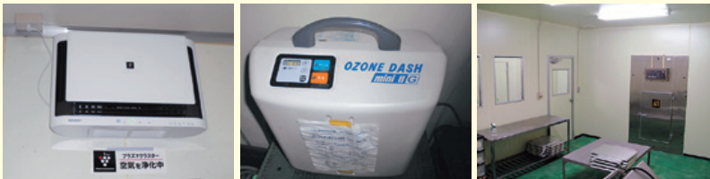
プラズマクラスターやオゾン水などの設置による衛生管理システムの導入
